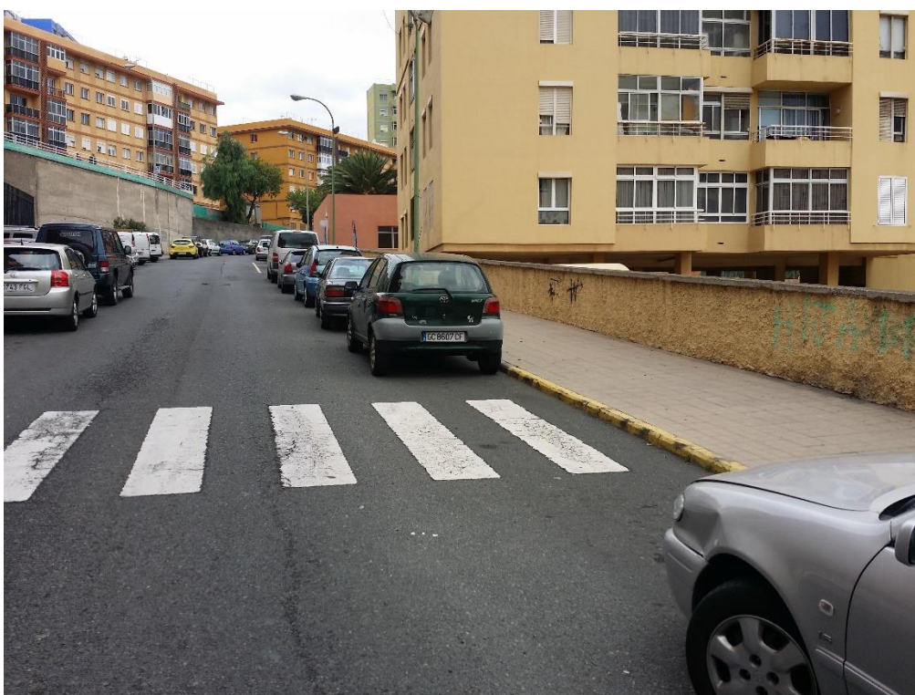
Img.8. paso de peatones sin rebaje y mal estado de la calzada.
