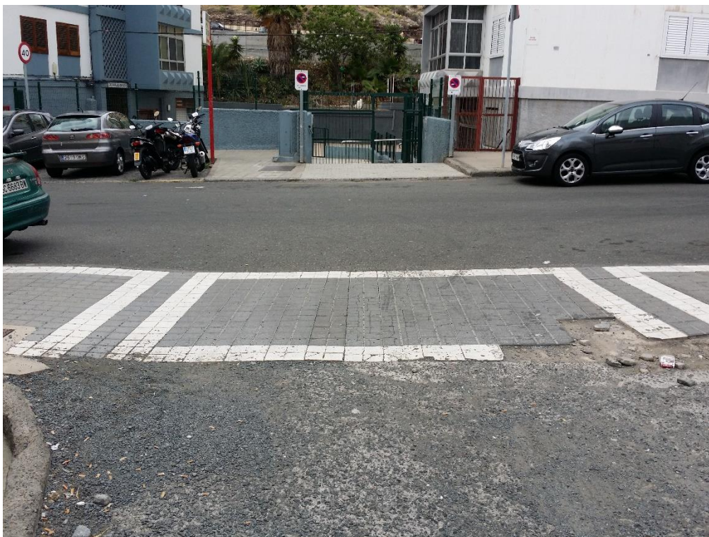
Img.5.: Acera en mal estado.
