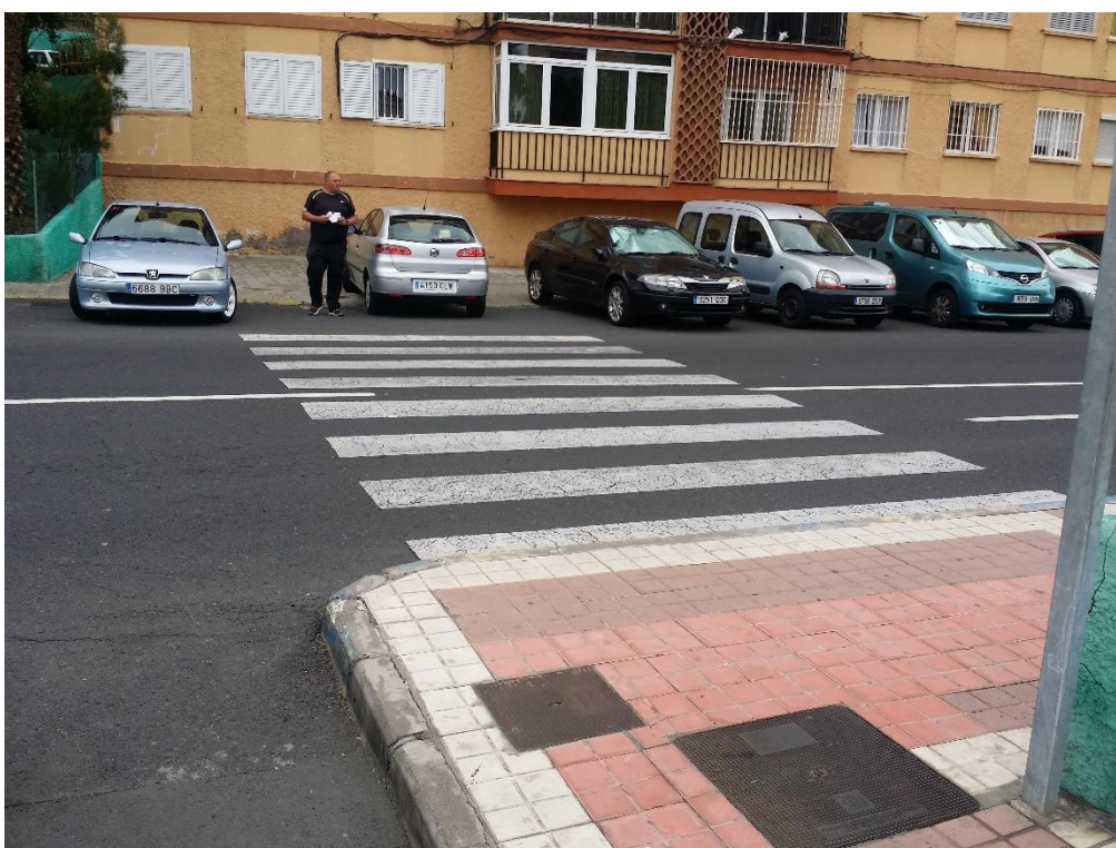
Img.10. Paso de peatones sin rebaje.
