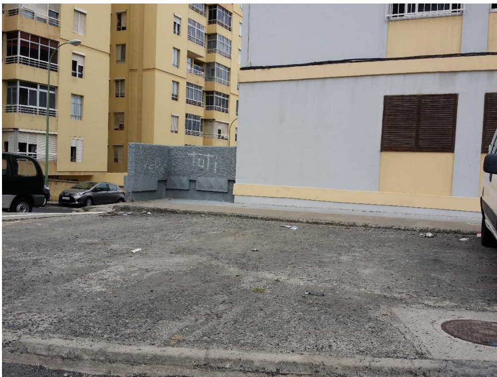
Img.7. Zona deteriorada de pavimento.
