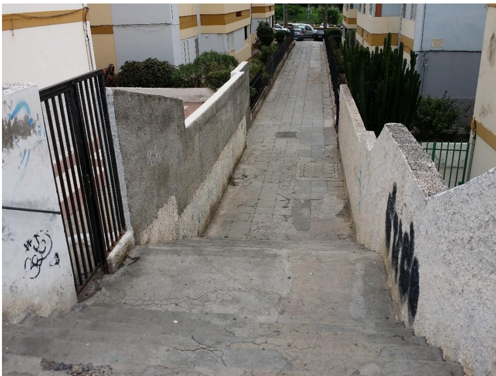
Img.1. Pasillo que conecta dos calles en mal estado.
