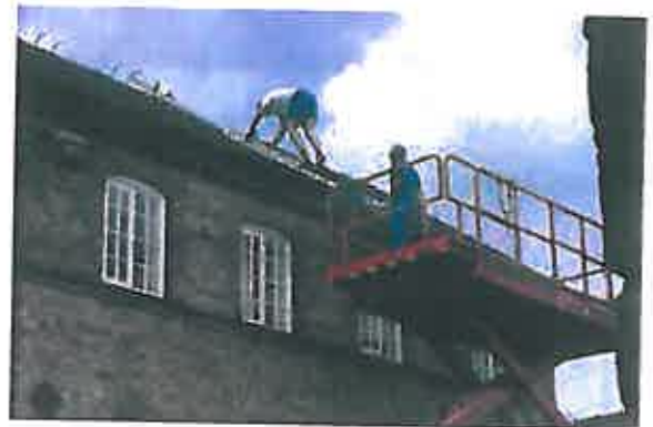
Figura 30. Uso indebido de la PEMP.
