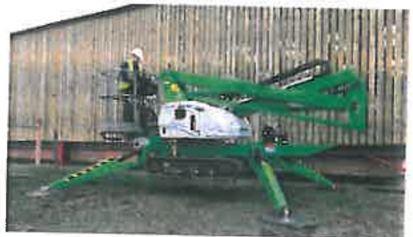
Figura 15. Estabilizadores hidráulicos con placa de apoyo.
