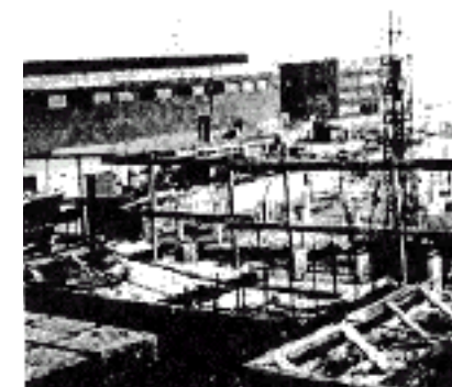
Forjado protegido con barandilla
