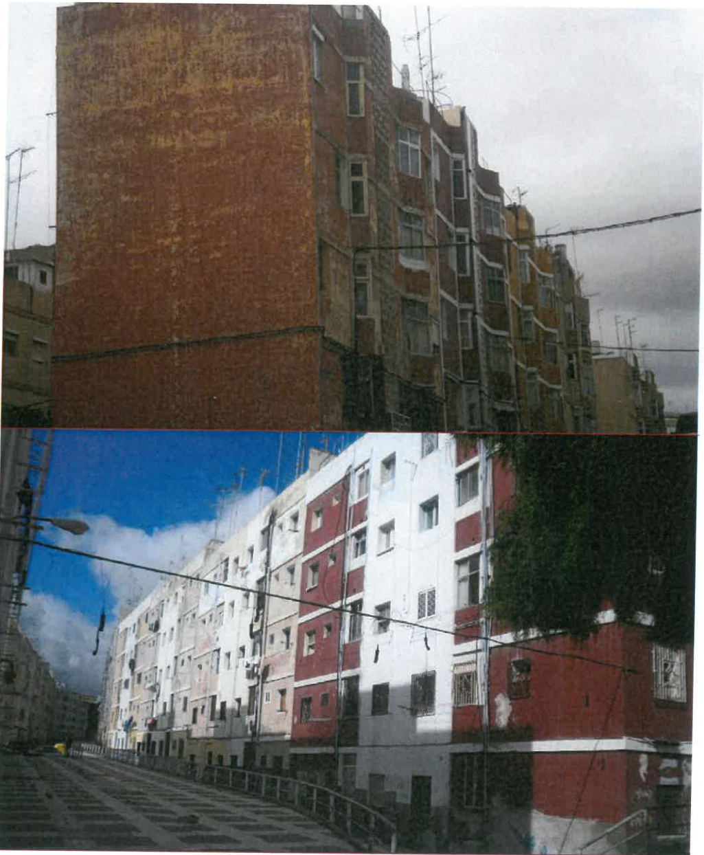
Deterioro en fachada principal (foto superior) y en fachada trasera (foto inferior).
