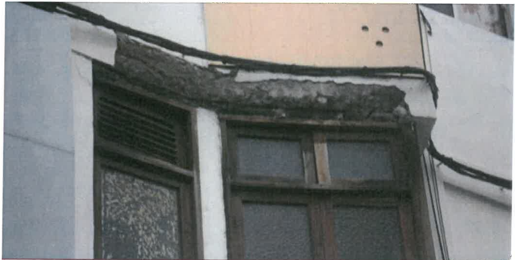
Detalle del deterioro en fachada principal.
