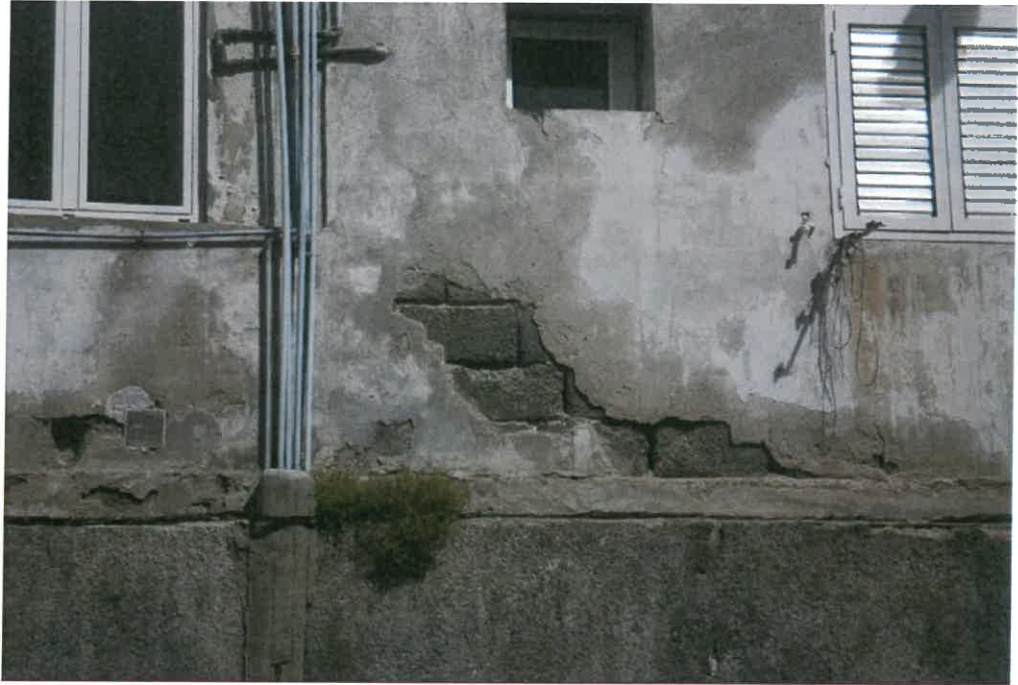
Detalle del deterioro en fachada trasera.
